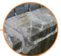
Poškodená dilatačná špára
